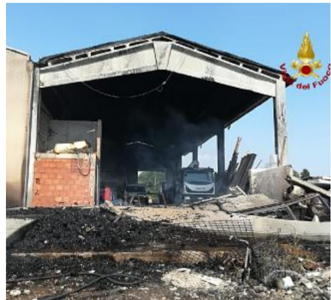
I danni causati dall'esplosione della bombola di gpl
