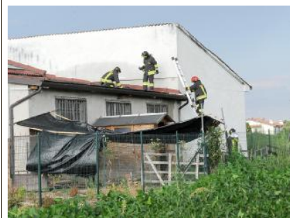
Soccorritori al lavoro nel magazzino andato in fiamme DIENEFOTO
