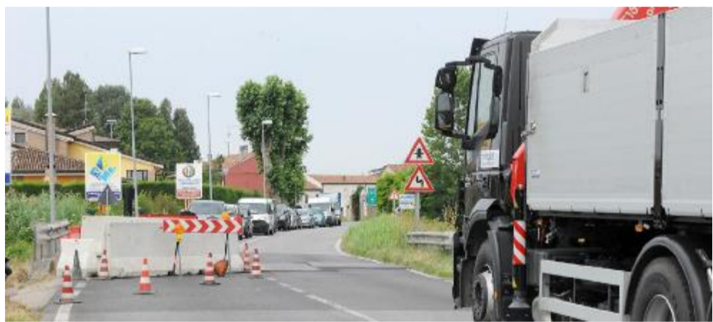
Il ponte sul fiume Tartarello, lungo la Regionale 10, crollato parzialmente lo scorso giugno
