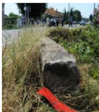
Il muretto pericoloso
