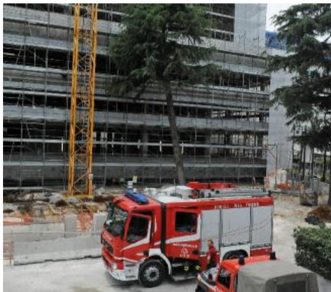
Il cantiere del Policlinico dove è avvenuto il grave infortunio
