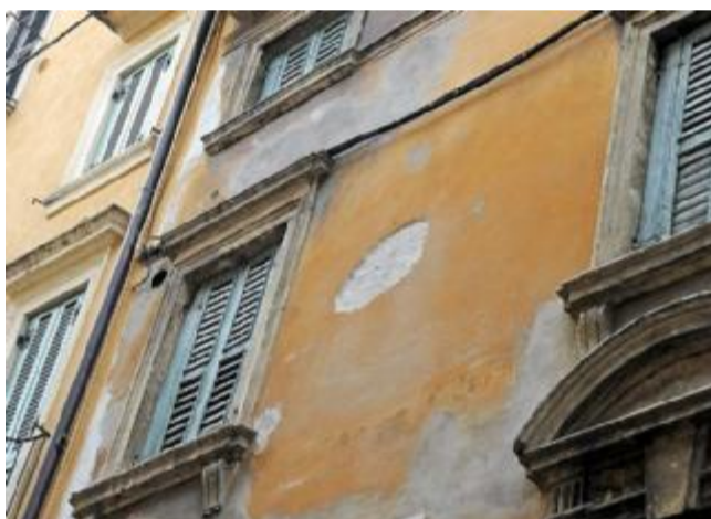
L'intonaco scrostato nell'edificio di via Cappello
