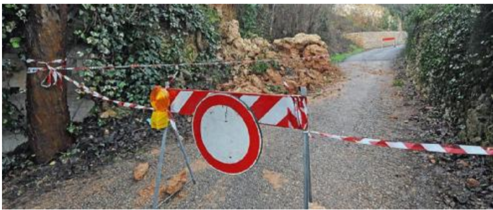
Via Abate Caliaro a Poiano. La polizia locale ha chiuso la strada dopo la caduta di un masso DIENNEFOTO
