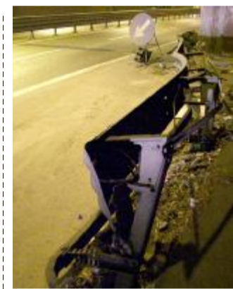
Un guard rail lesionato nel tunnel
